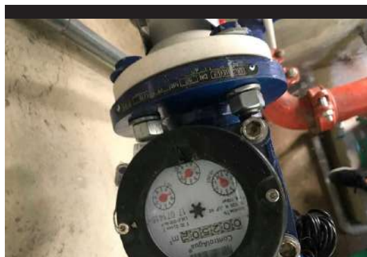
Figura 11.11. Medidor de consumo de agua potable
