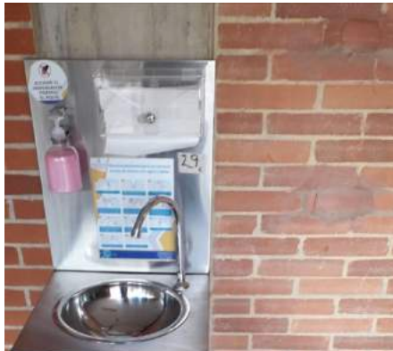
Figura 10.6. Lavamanos + Contenedor de residuos
